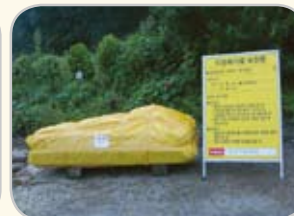
밀봉 및 석면 경고표지 부착 후 임시보관 장소 보관 예
